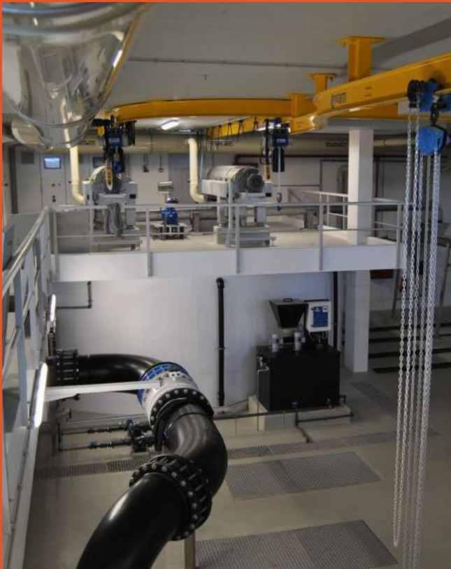
ETAR de Câmara de Lobos - Madeira, Região Autónoma da Madeira / Câmara de Lobos Wastewater Treatment Plant - Madeira, Autonomous Region of Madeira
