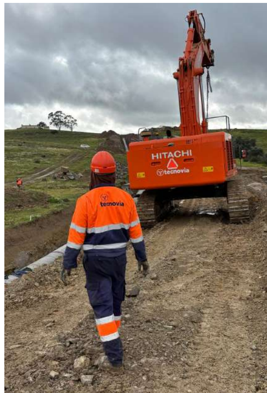
Circuito Hidráulico - Messejana, Portugal Hydraulic Circuit - Messejana, Portugal
