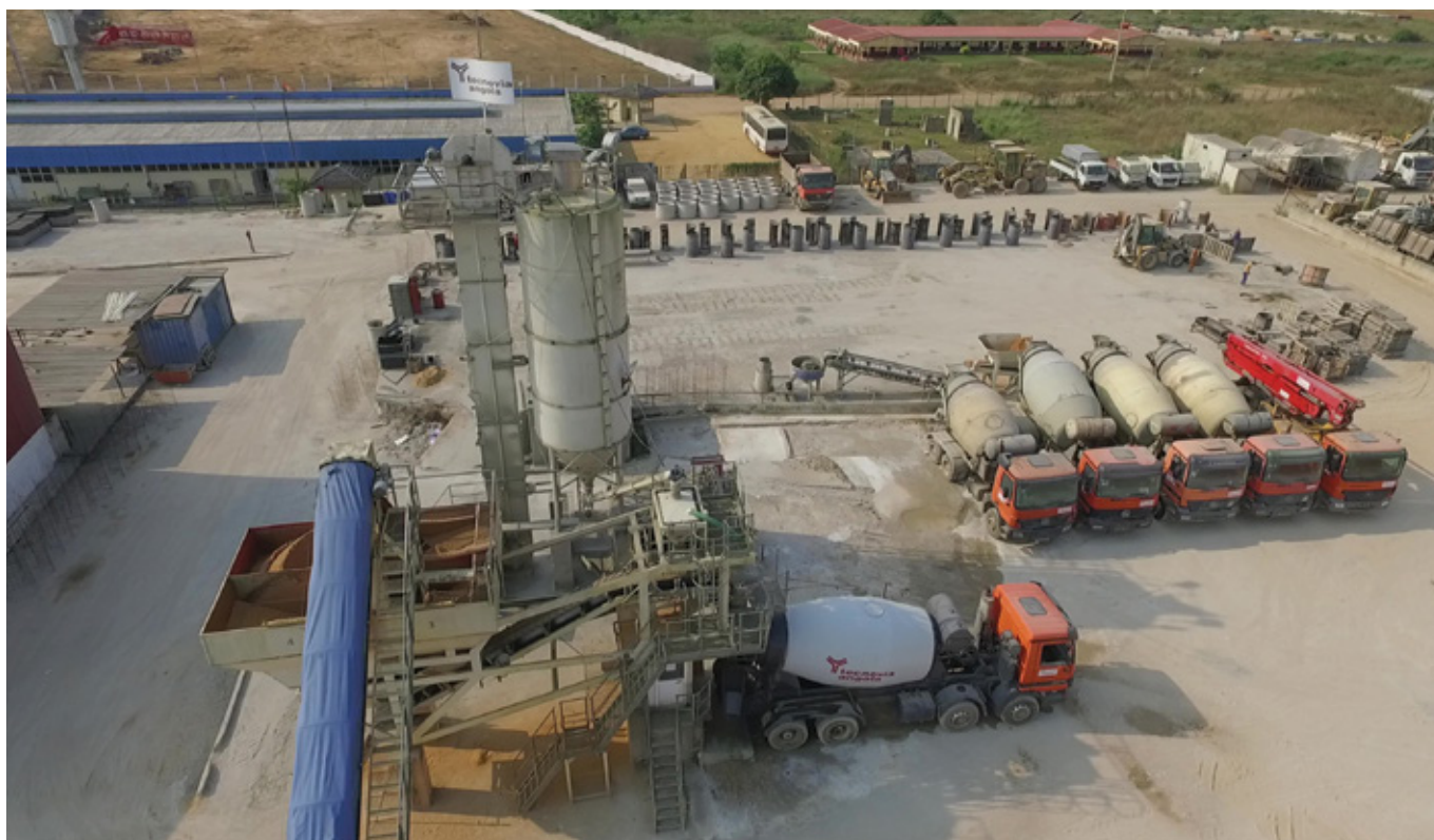
Centro Industrial do Caio Litoral – Central de Betão Hidráulico, Cabinda. Centre Industriel de Caio Litoral – Centrale à Béton Prêt, Cabinda. Caio Litoral Industrial Center – Concrete Plant, Cabinda.
